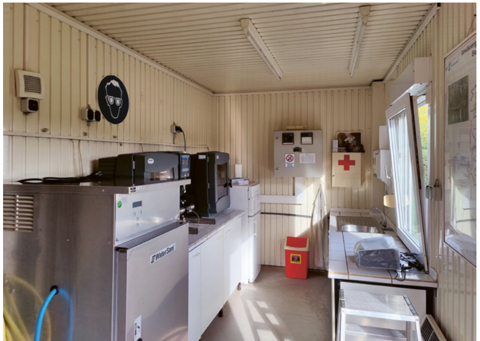
Blick ins Innere der Gewässergütemessstation in Bergheim
