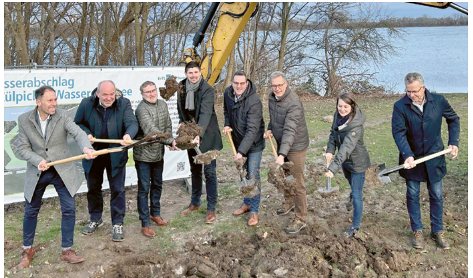
Am Spatenstich beteiligt (v.l.n.r.): Joachim Franzen (Stadt Zülpich, Geschäftsbereichsleiter Tiefbau), Professor Heinrich Schäfer (Ertfverband, Vorstand), Ottmar Voigt (Stadt Zülpich, Wiederaufbaubeauftragter), Michael Höhn (Stadt Zülpich, Allgemeiner Vertreter des Bürgermeisters), Marcel Schneider (Kreis Euskirchen, Untere Wasserbehörde), Ulf Hürtgen (Stadt Zülpich, Bürgermeister), Ronja Wenselau (Ertfverband, Projektleiterin) und Dr. Peter Kramp (Stadt Zülpich, Wiederaufbauberater)
