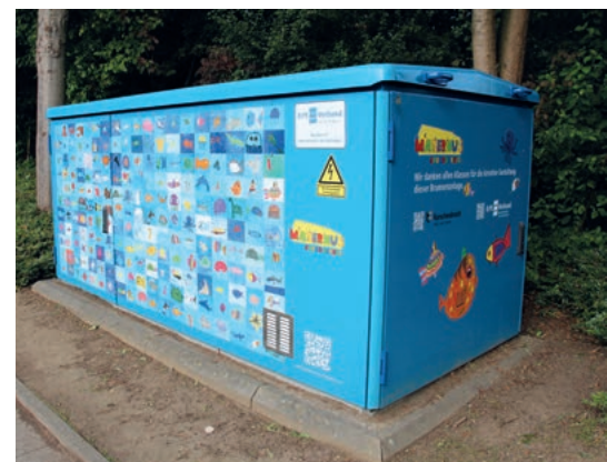
Eine der Kappungsanlagen: Brunnen 43 am Hallenbad in Kleinenbroich
