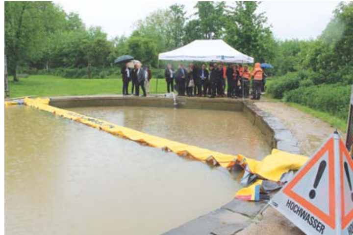
Demonstration der mobilen Hochwasserschutzwand der Stadt Rheinbach im Floßbecken
