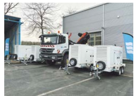
Netzersatzaggregate 60 kVA mobil
